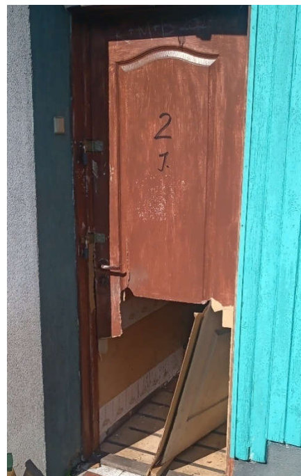
drzwi klasy RC1/RC2 sforsowane akumulatorową „flexą”
