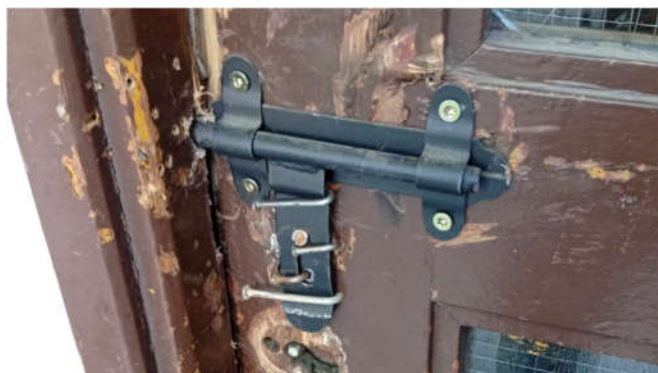
obiekt powłamaniovy prowizorycznie zabezpieczony przez załogę patrolową podczas interwencji
