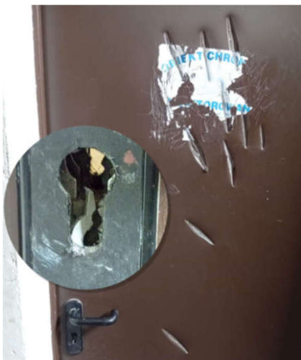
drzwi otwarte przez zniszczenie zamka, w napadzie szalu zmasakrowane siekierą – sprawca nadal może przebywać wewnątrz obiektu
