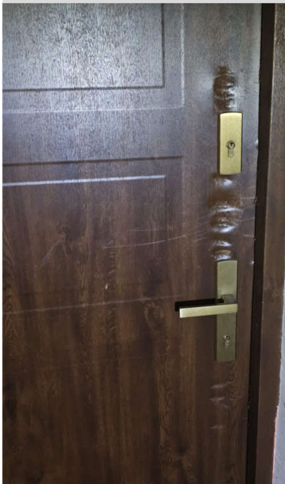
drzwi RC 4 po intensywnej i długotrwałej próbie wyłamania łomem.
