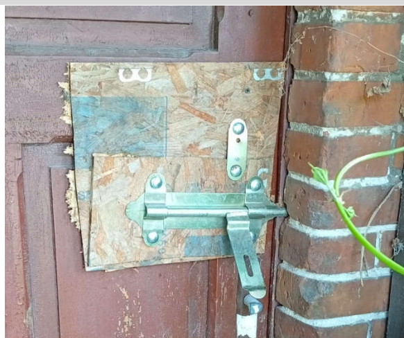
zerwana kłódka, zasuwa zamknięta – obiekt bezpieczny, choć sprawcy zapewne planują powrót
