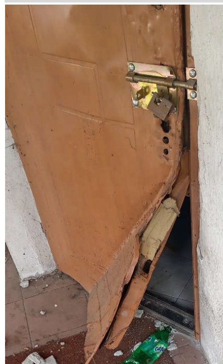
drzwi wzmocnione klasy RC3/RC4 sforsowane przez wylamanie
